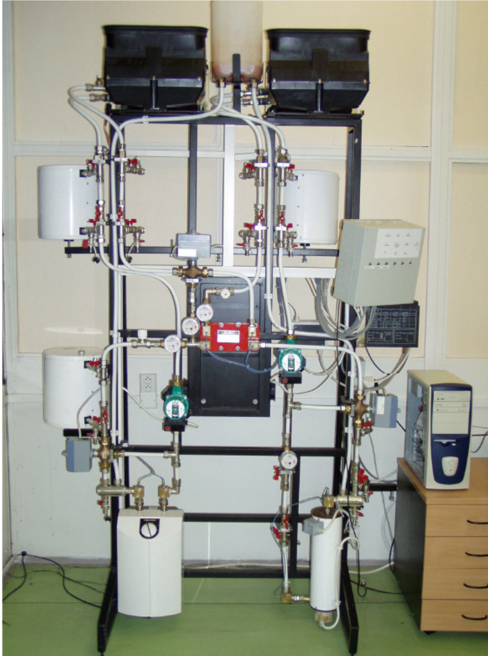
Obr. 2.2 Fotografie tepelné soustavy
